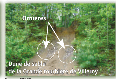
Ornières Dune de sable de la Grande tourbière de Villeroy Source : CRECQ
